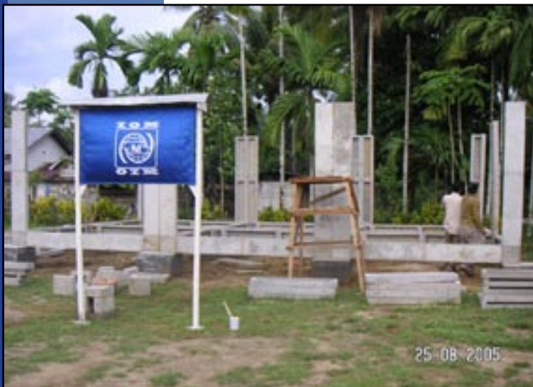
Para pekerja terlihat mendirikan batangan-batangan fondasi untuk Pos Kesehatan Satelit di Cot Seulamat, Aceh Barat. © IOM 2005
